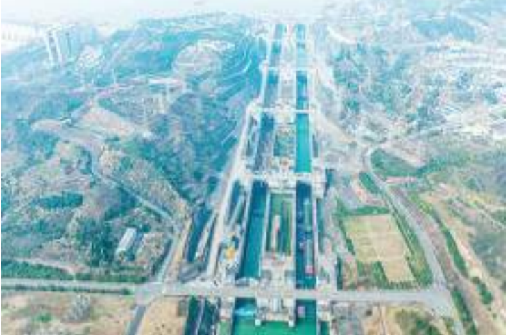
从2月21日8时起,三峡南线船闸开始停航实施计划性检修施工,工期30天。南线船闸停航期间,北线船闸继续运行。 新华社发(郑家裕 摄)
