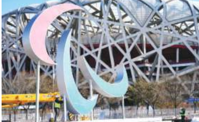
2月24日，工人在北京赛区国家体育场附近安装冬残奥会标志。
