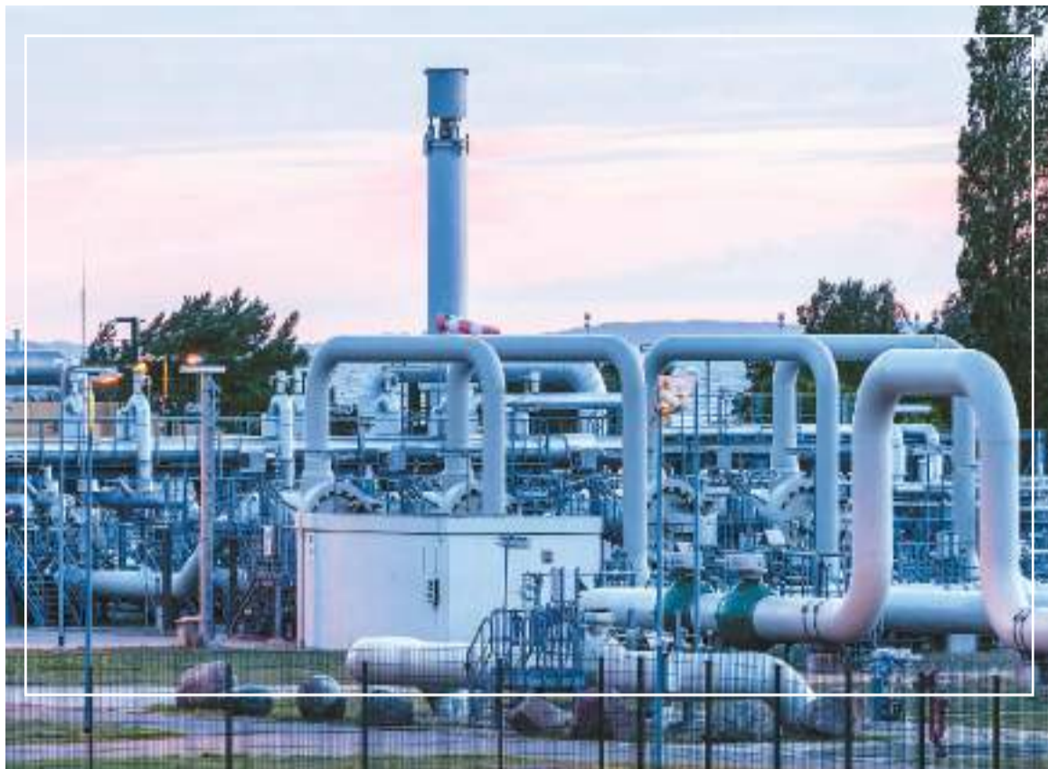
据报道,俄罗斯向欧洲输送天然气的主要管道“北溪1号”于莫斯科时间7月11日7时开始年度维修,管道供气已暂停,此次维修将持续至7月21日。图为7月11日清晨在德国北部城市卢布明拍摄的“北溪1号”输气管道相关设施。新华社/美联
