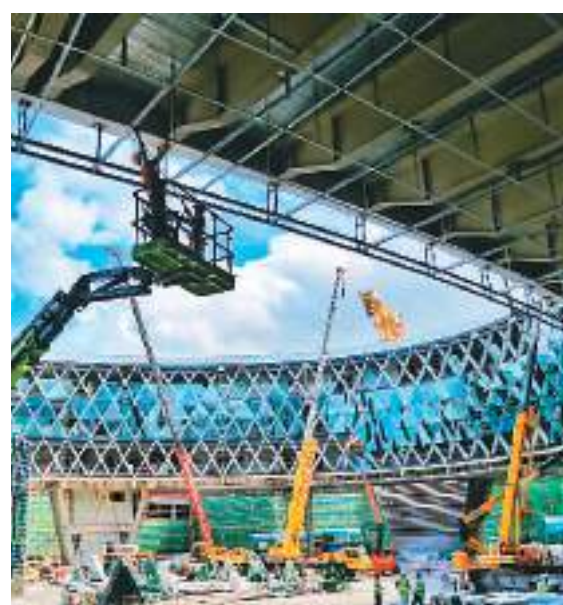
位于海南省三亚市崖州湾科技城的深海科技创新公共平台项目是海南自由贸易港建设重点项目，建成后重点发展深海科技和科教研产业，其中深海科技方面涵盖深海装备、深海材料、深海通讯、海洋船舶和海洋公共服务等。目前，该项目正在进行幕墙玻璃安装、机电安装等工作。图为项目建设现场。
