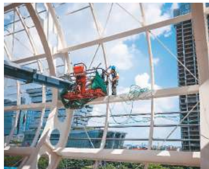
位于广东省广州市海珠区的广交会展馆四期扩建项目总建筑面积约56万平方米，建成后新增展位6000多个，是广交会展馆建设史上规模最大的扩建项目。目前，展厅、会议中心及东登录厅、西登录厅上建主体结构已封顶。图为7月8日，建设者正在进行展馆的钢结构涂漆作业。
