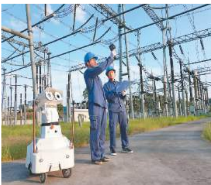
8月23日，在贵州省铜仁市500千伏松桃变电站，南方电网铜仁供电公司运维人员操作5G智能机器人对变电设备进行巡检，确保电网在持续高温、大负荷情况下安全可靠运行，切实保障迎峰度夏期间民生用电。 田杰摄（人民视觉）
