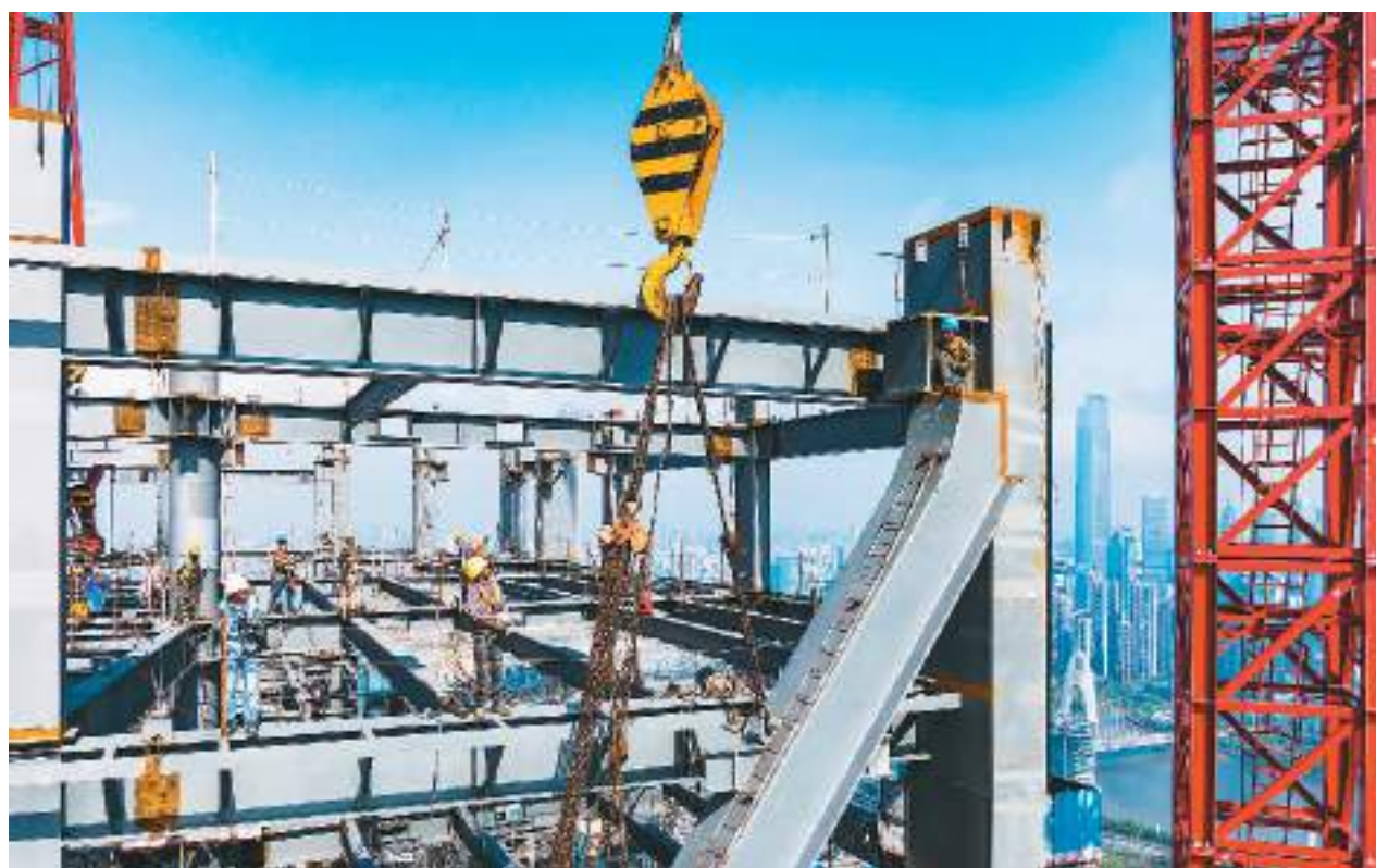
广东省广州市琶洲人工智能与数字经济试验区，是广深港澳科技创新走廊核心平台之一。目前，琶洲西区建设稳步推进，试验区建成后将成为互联网、电商、高科技等创新型产业集聚地。图为8月21日，建设者在项目现场作业。 魏劲松摄（人民视觉）
