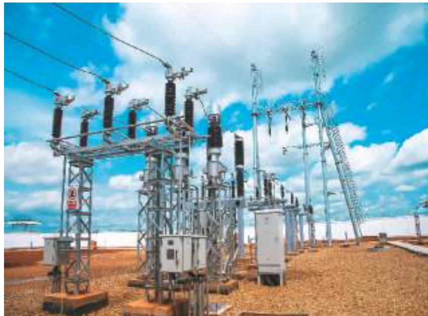
萨卡伊光伏电站是中非共和国首座光伏电站该电站，位于该国首都班吉附近的索博市，由中国能源建设集团天津电力建设有限公司总承包，装机容量为15兆瓦，其落成极大缓解了班吉的用电难，促进了当地社会经济发展。图为6月2日拍摄的萨卡伊光伏电站升压站。
