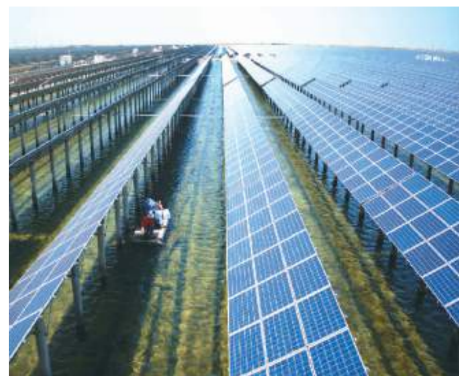
山东省东营市河口区充分利用立体空间，融合“风、光、海、渔”等资源要素，大力发展光伏发电、风力发电等绿色新能源产业，实现经济、生态双丰收。目前，河口区新能源发电装机容量达118万千瓦，新能源年发电量突破18亿千瓦时。图为位于河口区万亩生态渔业区浅滩内的曙光汇泰光伏电站，当地供电公司工作人员乘船巡检光伏设备。党秀娟摄（人民视觉）
