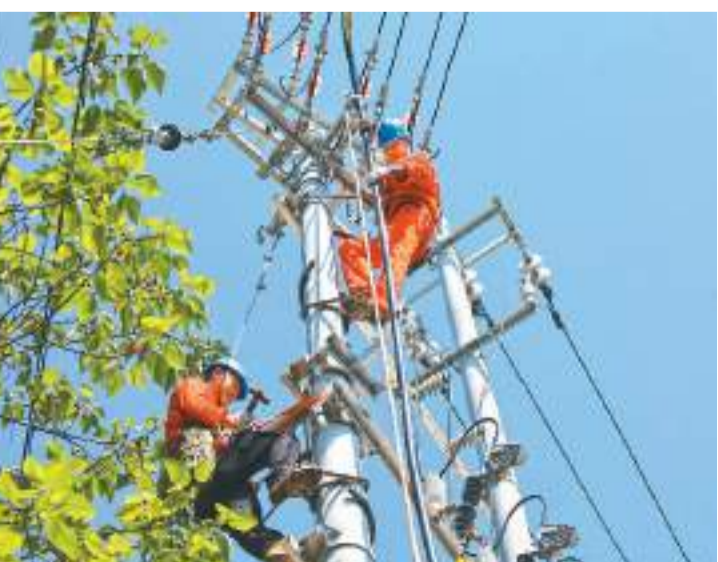
安徽省广德市围绕乡村振兴战略，实施农村电网巩固提升工程，乡村电网补强工作取得成效。近两年，国网广德市供电公司累计建改项目111个，农网户均容量达到4.45千伏安。图为近日电力工人在广德市乡村进行桃园2号台区分容作业，以增强供电可靠性。
