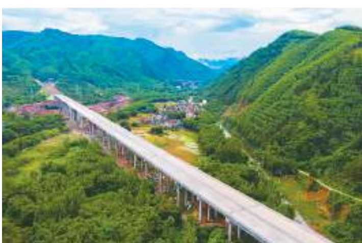
广西壮族自治区平南至武宣高速公路建设正加快推进。该项目全长62.837公里,采用双向四车道高速公路建设标准,设计行车速度120公里/小时,是广西高速公路网的重要组成部分。图为近日由中建路桥集团有限公司承建的平武高速公路航拍画面。 侯宇浩摄
