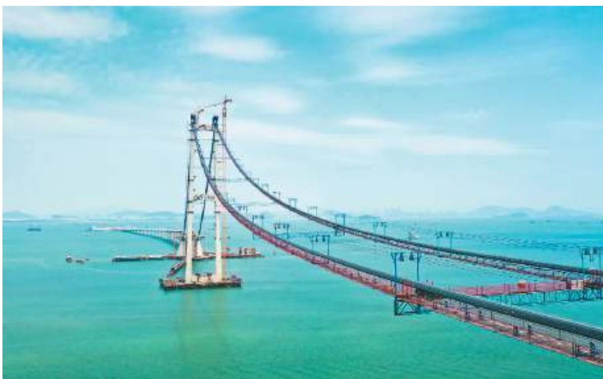
深中通道伶仃洋大桥主缆日前完成全部架设，这座世界级工程又实现一项重大建设节点突破。
