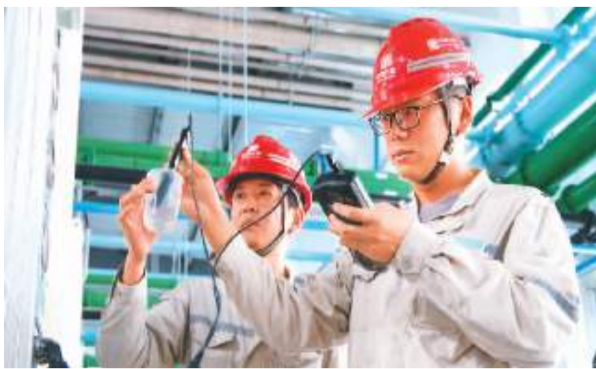
▲大唐东营发电有限公司采用反渗透法技术对海水进行淡化处理，其海水淡化系统淡水产量达到8640吨/日，投运后累计产水250余万吨，较好解决了企业用水需求。图为近日，工作人员对海水淡化设备进行检测。郭俊峰摄（人民视觉）
