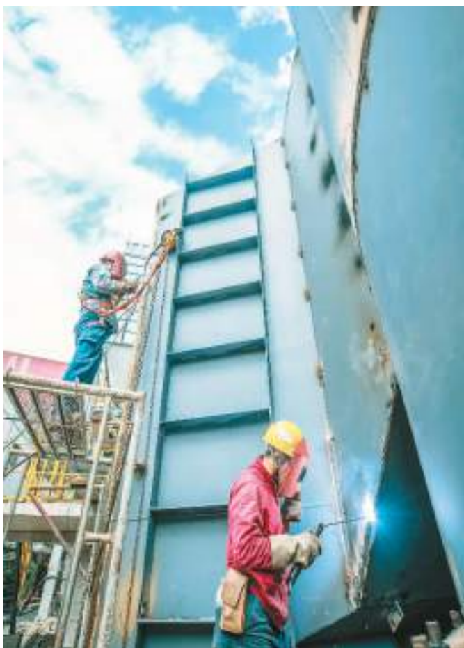
近日，在安徽省马鞍山市，中国宝武马钢股份特钢公司除尘环保设施改造升级项目正加紧施工。 罗继胜摄（人民视觉）
