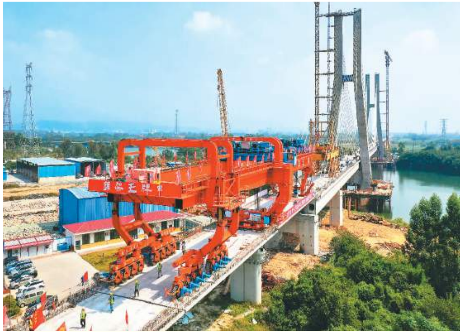
近日，中铁五局承建的广汕铁路铺架施工最后一孔900吨箱梁成功架设在广东广州增江特大桥桥墩上，标志着全线箱梁架设完成。设计时速350公里的广汕铁路全长206.2公里，途经广州、惠州、深汕合作区、汕尾，全线预计2023年建成通车。通车后，广州到汕尾运行时间将由现在的2小时左右缩短至40分钟左右，将有力助推粤东地区加快融入粤港澳大湾区。
