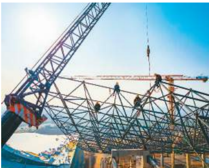
正在建设中的山西省运城会展中心项目建成后，能够满足运城国际果品博览会、大型农展会等会展需求，助力打造全国性的果品价格中心、交易集散中心、行业信息中心和出口展销中心。图为11月16日，山西省运城会展中心项目建设现场，工人在架设展馆钢结构，全力推进展馆建设及配套工程施工。常奇摄（人民视觉）
