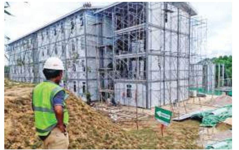
政府在新都赶建住房工程 11月6日,在坐落于东加省北八纳线巴塞(Penajam Paser Utara)县的新都建设工程,一名建筑工正在监督供基础设施建筑工人住房的建设进展。
