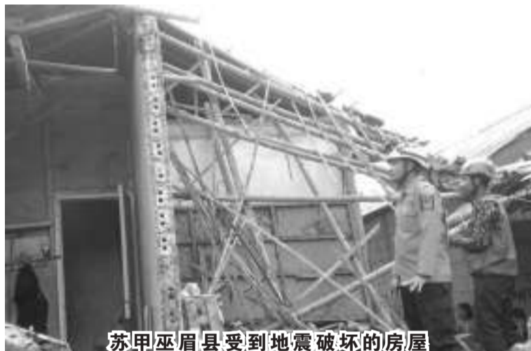
苏甲巫眉县受到地震破坏的房屋
