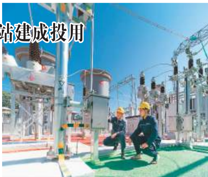
图为广州供电局员工在500千伏科北变电站现场检查设备。
