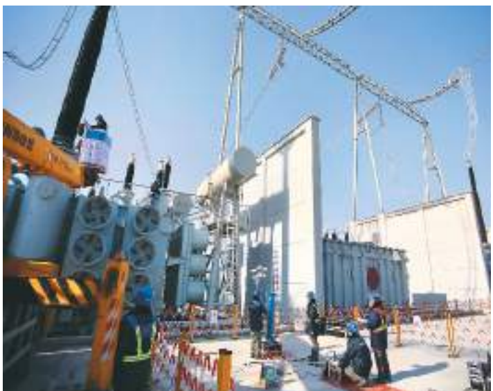
北京东1000千伏变电站是距离首都最近的特高压变电站。预计北京东扩建工程建成后增加京津冀地区600万千瓦供电能力。图为位于河北省三河市的北京东1000千伏变电站。本报记者 赵树雯摄
