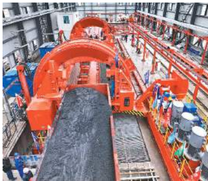
1月15日，由江苏省南通市沿海集团承建的洋吕铁路东灶港站物流项目输煤系统重载联调顺利完成。项目建成后，可保障中铁钢铁600万吨/年的煤炭运输任务。 许从军摄（人民视觉）
