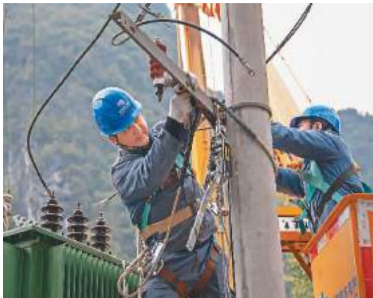
入冬以来，南方电网广西新电力集团靖西供电公司组织技术骨干对辖区供电设备和线路进行全面检查维护，确保电网供电可靠性，保障居民用电安全。图为1月4日，电力技术人员在广西靖西市靖镇三联村头葛屯变压器架上作业。
