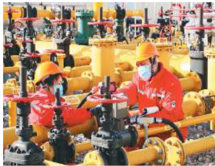
春节前夕，山东省东营市东营区以优先保障民用天然气为重点，结合用气量、气源点、输差等参数对所辖站点、管网实行24小时在线监控，并按供需变化适时调配气源，全力保障居民节日期间安全平稳用气。图为1月15日，在东营区庐山路配气站，胜利油田员工对天然气管网进行巡检。
