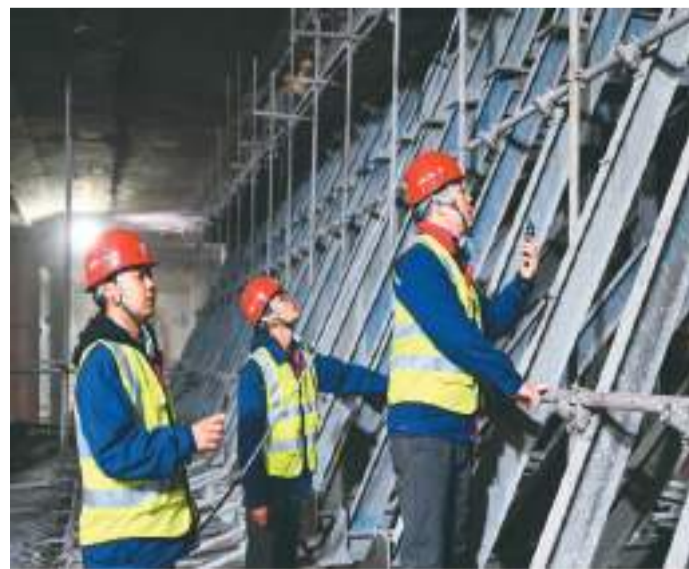
4月11日，由中铁二十二局承建的长春地铁6号线飞跃广场站、欧亚卖场站主体结构及两站区间工程完工，标志着工程建设取得阶段性进展。据介绍，长春地铁6号线全长29.57公里，共设车站22座，连接长春市西部新城、高新南区等重要功能区，建成通车后将进一步改善当地交通，助力优化城市空间布局。图为技术人员正在项目现场检查。宋强摄(人民视觉)
