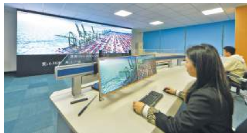
显示屏展示智慧江阴港可视化管理系统。
