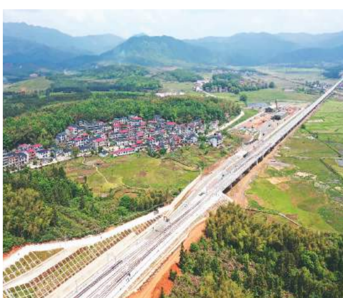
4月26日,昌(南昌)景(景德镇)黄(黄山)高铁全线铺轨贯通。昌景黄高铁建成通车后将连接杭(杭州)黄(黄山)高铁,有利于拉动沿线旅游产业发展。图为江西省景德镇市浮梁县境内建设中的昌景黄高铁。 时 雨摄(人民视觉)
