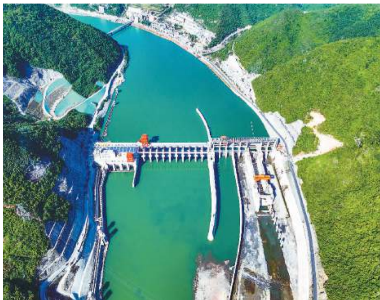
日前,湖北省十堰市郧阳区汉江孤山电站左岸船闸进入设备安装环节。汉江孤山电站工程于2016年12月25日开工兴建,总投资34.86亿元,水库总库容为2.12亿立方米,装机容量为180兆瓦,是一座以发电为主兼航运的综合民生工程。图为汉江孤山电站。
