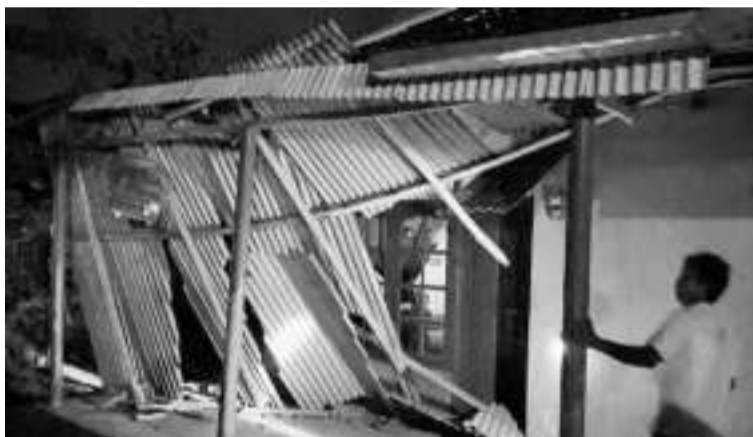
班图尔县(Bantul)某一房屋受到地震损坏。
