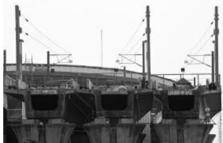
哈林高铁站施工进度达97.3% 8月12日,印尼高铁公司声称,雅万高铁哈林站的施工进度已经达到97.32%,并预定今年8月底竣工并开始投运。
