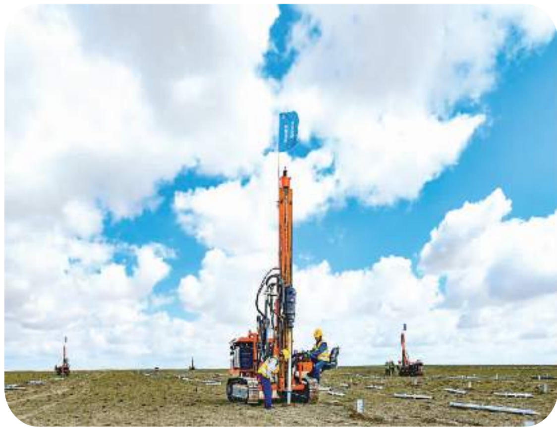
近年来，地处毛乌素沙漠腹地的内蒙古自治区鄂尔多斯市鄂托克前旗，充分利用沙漠腹地富集的光能和风力资源优势，大力发展绿色能源产业。图为8月27日，打桩机在鄂托克前旗一处光伏电站项目建设工地施工。
