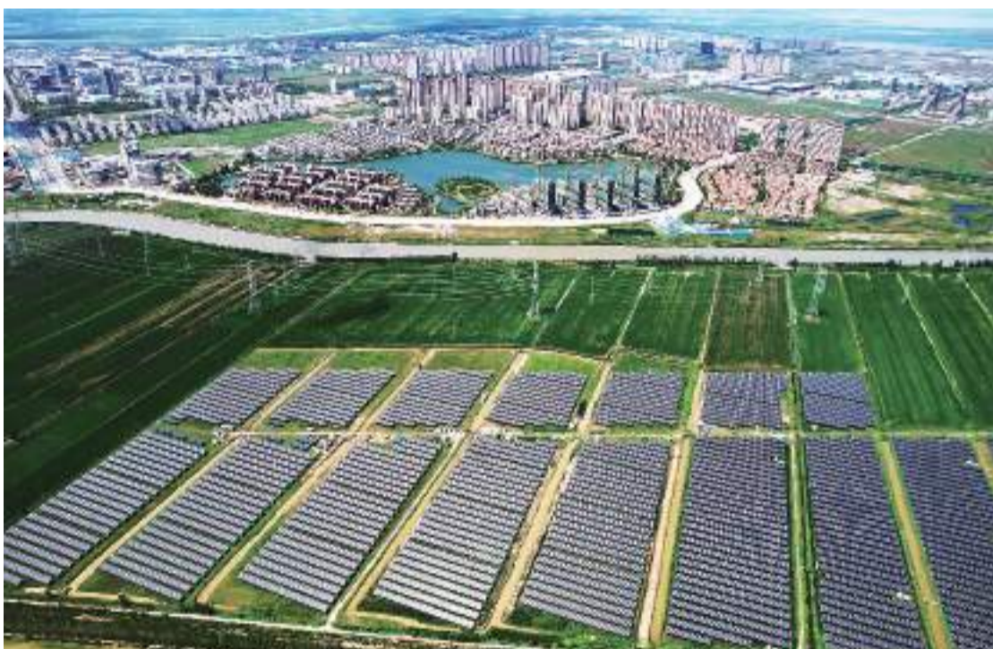
8月30日拍摄的位于江苏省连云港市经济技术开发区朝阳街道内的一处光伏发电项目。 耿玉和摄（人民图片）
