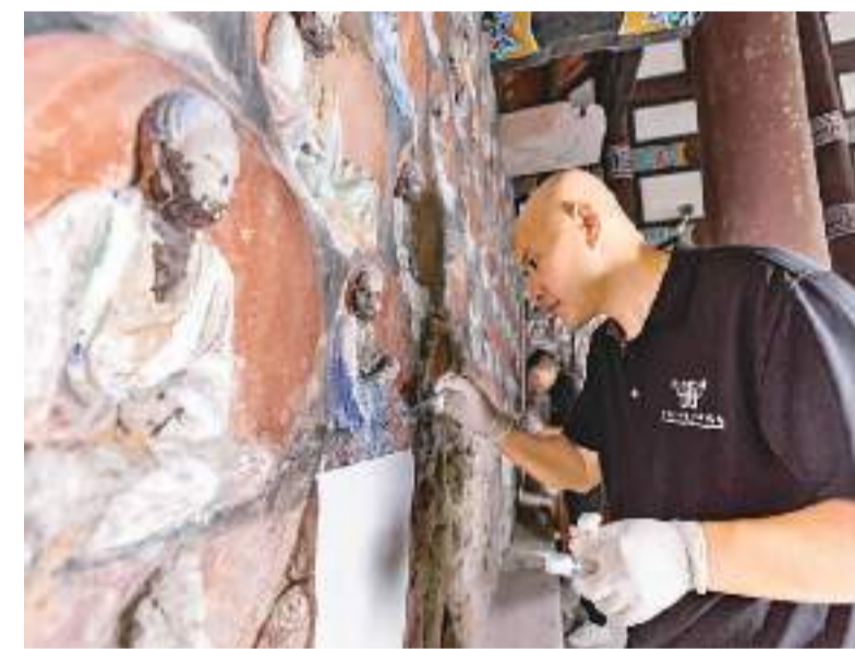
日前，在大足石刻小佛湾摩崖造像保护工程现场，工作人员对石刻造像病害进行处理。 新华社记者 黄伟摄
