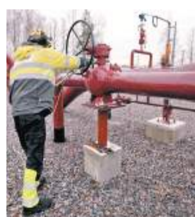
◆管道因洩漏出現壓力異常下降，被迫關閉閘門。資料圖片
