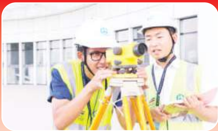
7月21日,在印度尼西亚万隆雅万高铁德卡鲁尔车站外,中铁四局雅万项目部印尼籍工程师斯万达鲁(左)向他的中国师傅学习水准测量。新华社记者徐钦摄
