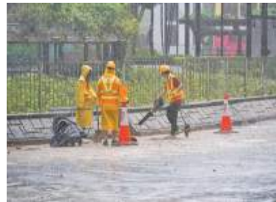
工人在環翠邨抽走積水。
