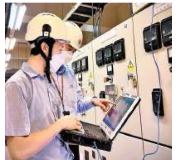
港燈團隊研發「智能斷路器監察和分析系統」令每年高壓電纜出現異常事故下降四成。
