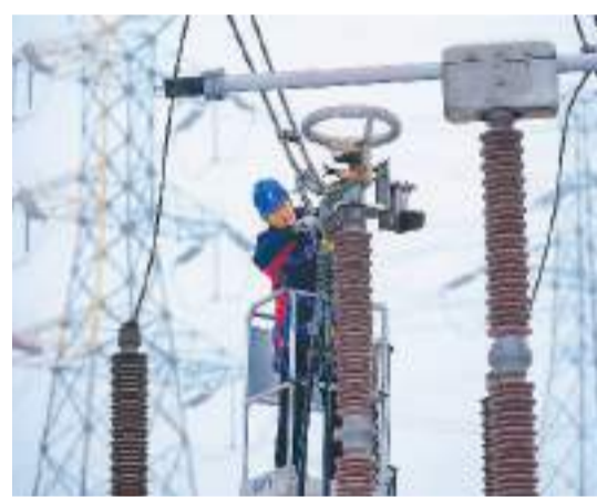
近日，山西省运城市积极开展雨雪冰冻灾害天气防范应对工作，对易覆冰输电线路开展全天候检测并开展融冰作业，保障电网安全稳定运行。图为国家电网运城供电公司工作人员在开展融冰作业准备工作。闫 鑫 摄
