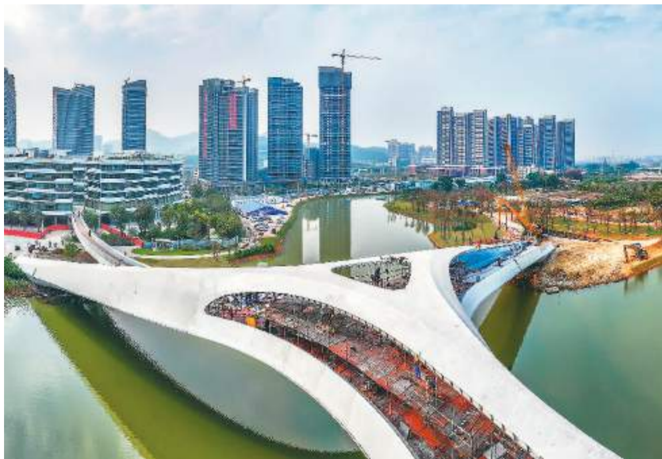
连日来，位于广东省广州市南沙区的人行景观桥聚星桥正在进行最后的收尾作业。聚星桥是国内首座三股星型人行景观桥，造型新颖独特，三岸起拱相互支撑成桥，寓意粤港澳三地携手、汇聚力同心，共创大湾区美好未来。图为工人们在桥上施工。王美燕摄（人民视觉）
