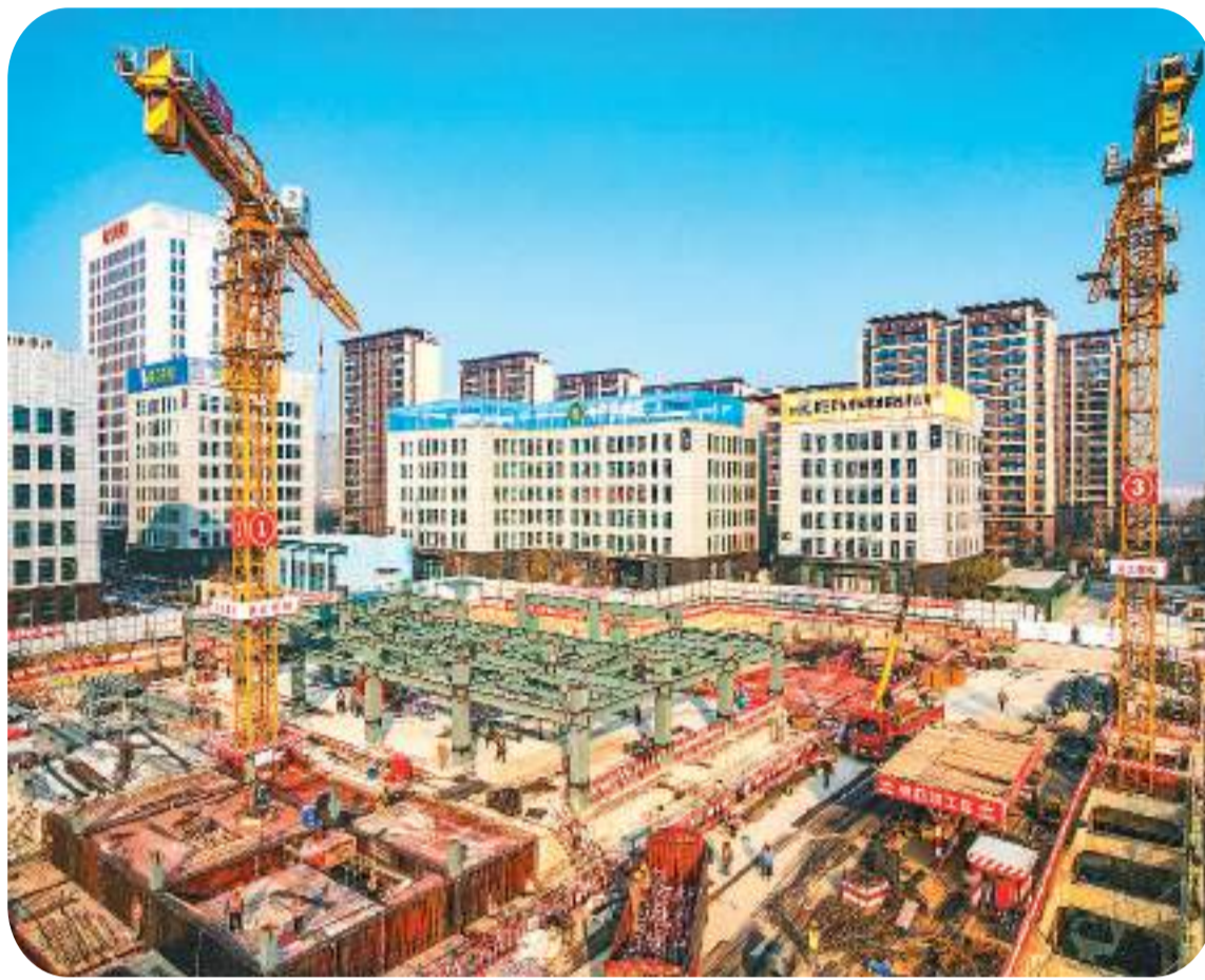
▲江苏省宿迁市电子商务产业园区电商大厦工程项目是市级重大产业项目，建成后有助于推动当地电商产业发展。图为电商大厦工程施工现场，塔吊林立，工人正在加紧施工。
