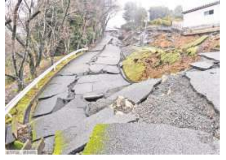
当地时间1月6日,石川县穴水町通往穴水高中的道路因地震坍塌。
