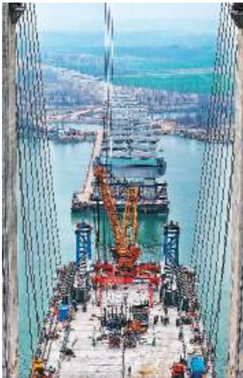
春节假期刚过,湖北襄阳各重点工程建设迅速进入“快车道”。图为2月18日,在湖北襄阳牛首汉江特大桥施工现场,施工人员进行吊装作业。 谢 勇摄(人民视觉)
