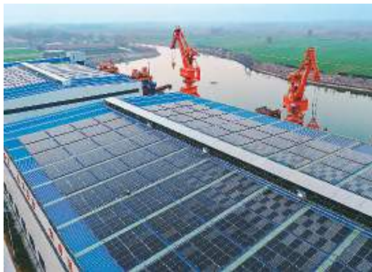
安徽省淮北市孙疃港1.54兆瓦分布式光伏建设项目，是安徽省首个零碳港口建设示范项目。项目以智慧用能平台为支撑，以绿电交易为补充，实现数据互联互通和资源精准调节，推动港口绿色低碳转型。
