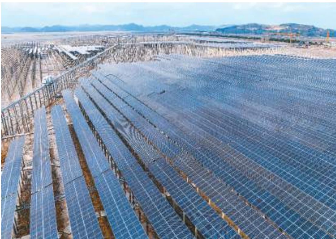
2月5日,浙江省温岭市南海涂渔光互补光伏电站项目一期工程正式并网发电,后续还将建设二期、三期工程。工程全部完工后,该光伏电站年发电量预计达7亿千瓦时。图为项目现场。徐俊杰摄(人民视觉)
