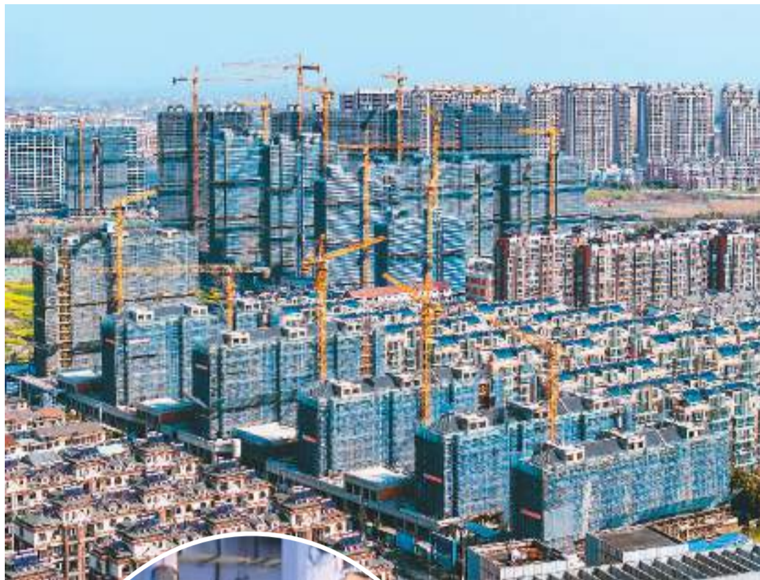
近期，江苏省海安市出台试行商品房“以旧换新”政策，计划今年实施商品房“以旧换新”100套。图为海安高新区的一处住宅项目正在施工。
